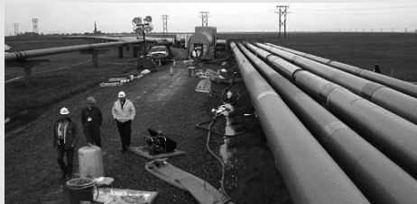
Pipeline-Leck bei BP in Alaska im August 2006 Quelle: BP
